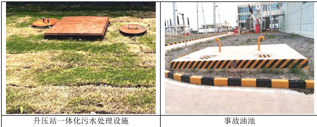
图 2-4 硕风升压站站内环保设施现状
