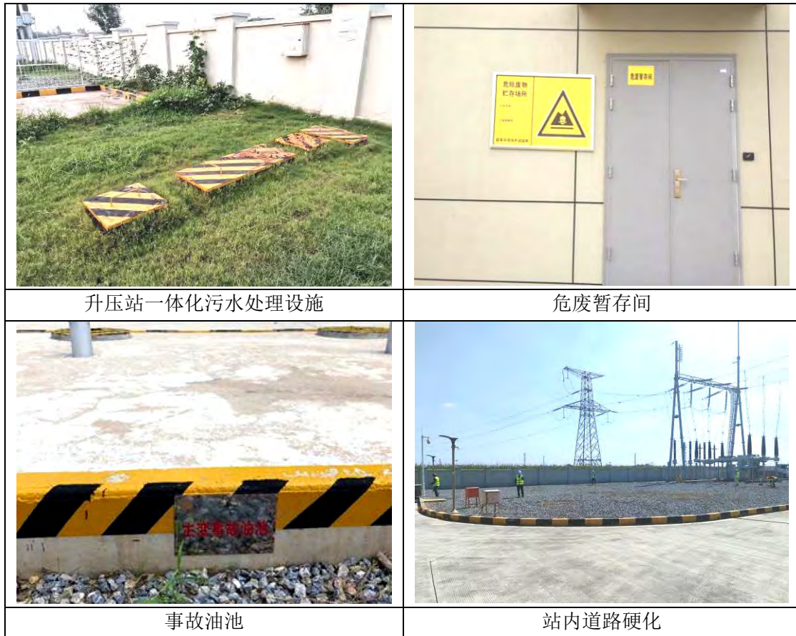
图 2-3 强风升压站站环保设施/措施现状
